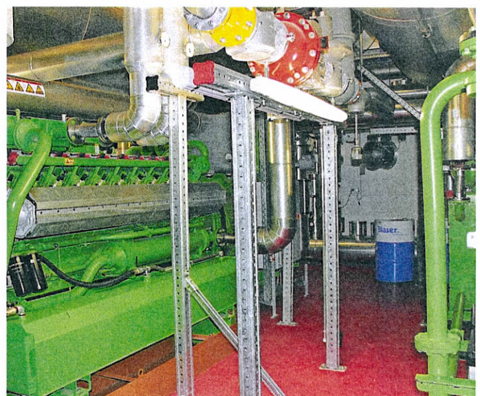
Aus der Energie wird Strom und Wärme. Der Strom geht ans EW Zürich, die Abwärme heizt das Pflegeheim Reusspark.
