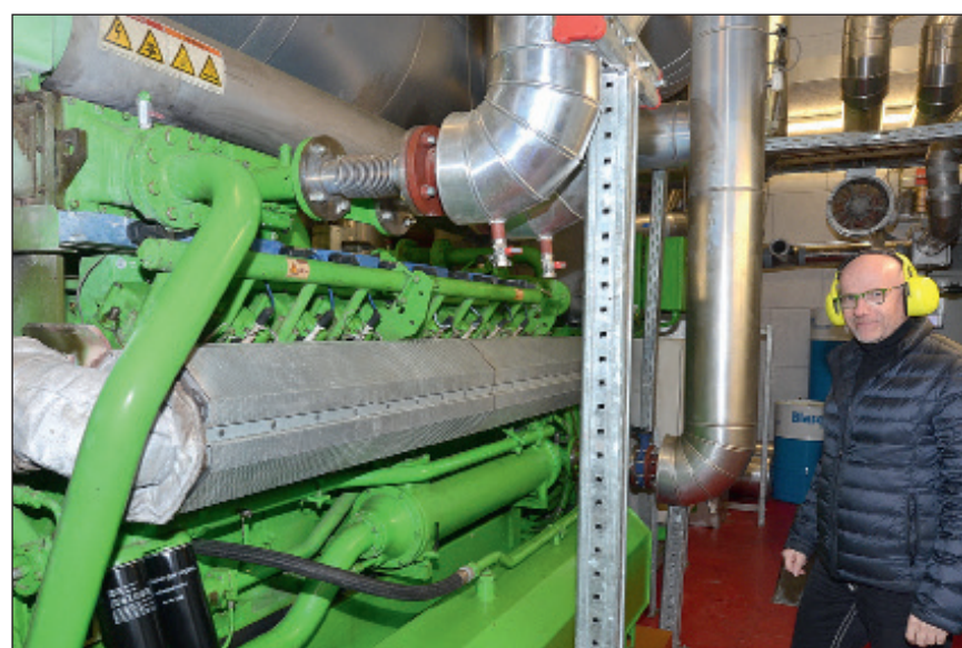
Werner Humbel im Generatorraum. Zwei riesige, mit Gas getriebene Generatoren produzieren rund um die Uhr Strom und Wärme.
